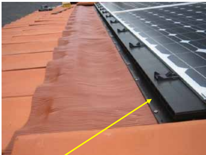
Boitiers de ventilation (en bas également !)
